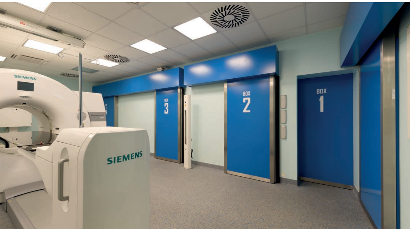
Nezbytným vybavením rentgenového pracoviště jsou dveře s RTG odolností.
